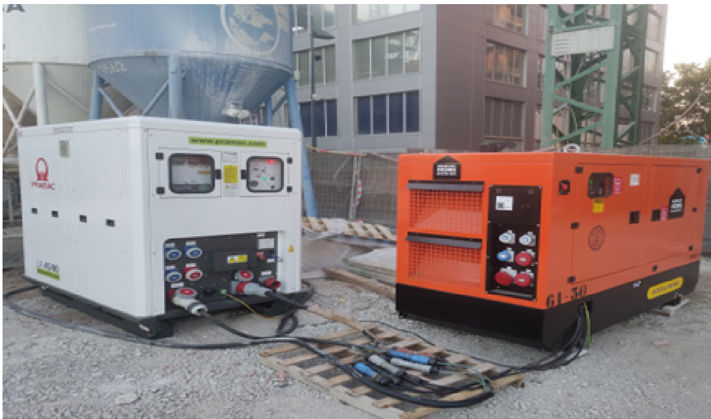
Equipos de generación eléctrica en el emplazamiento de pruebas
